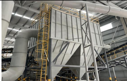
原料制备布袋除尘器
