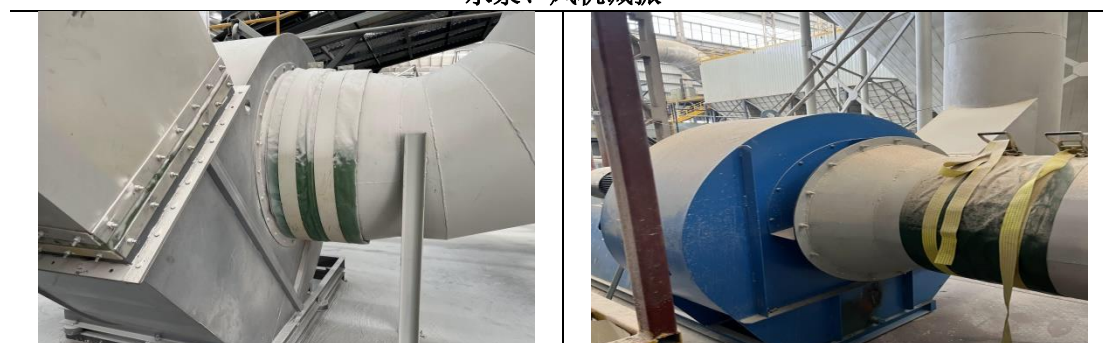
废气治理设施管道柔性连接
